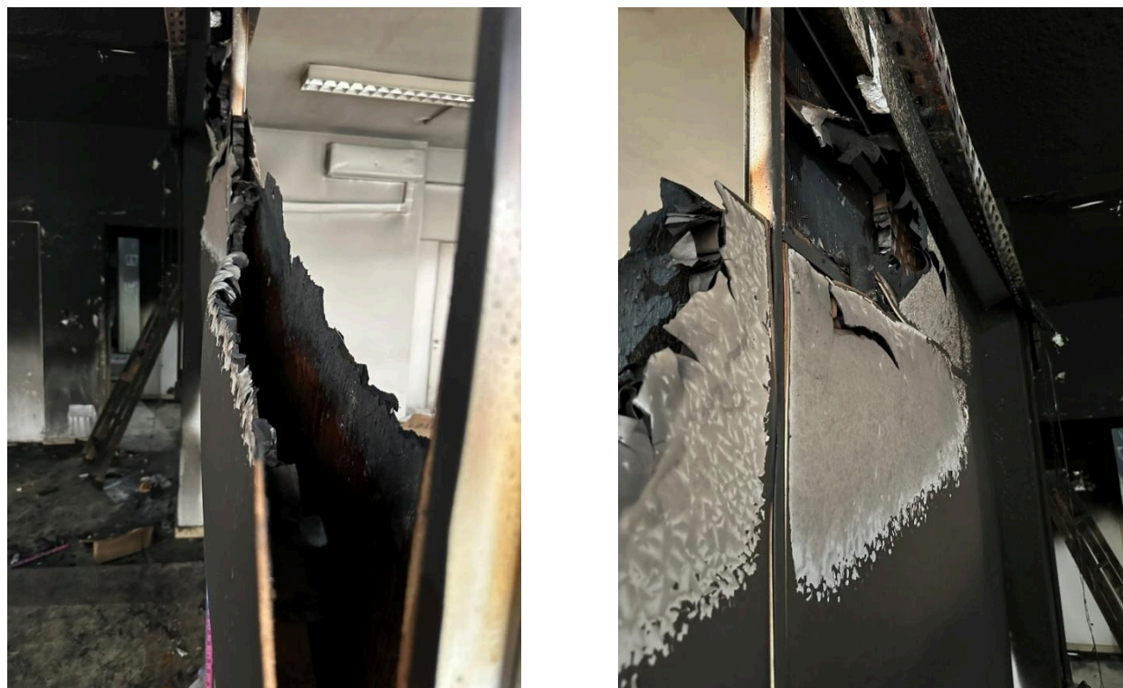
Foto 21: Vista da divisória danificada
