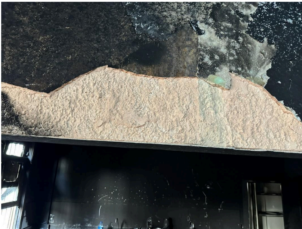
Foto 14: Deslocamento na viga
