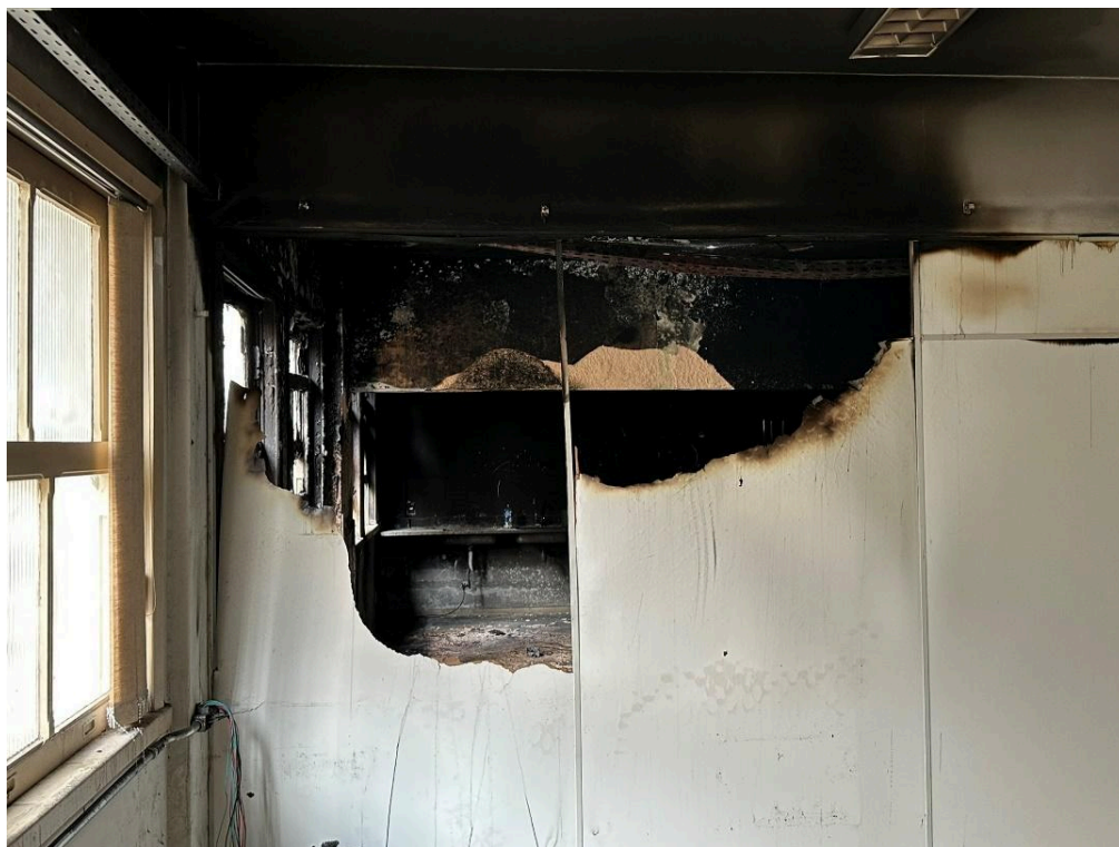
Foto 20: Vista da viga e divisória danificada
