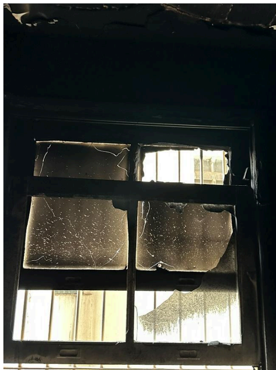
Foto 18: Vidros das janelas danificados pelo calor
