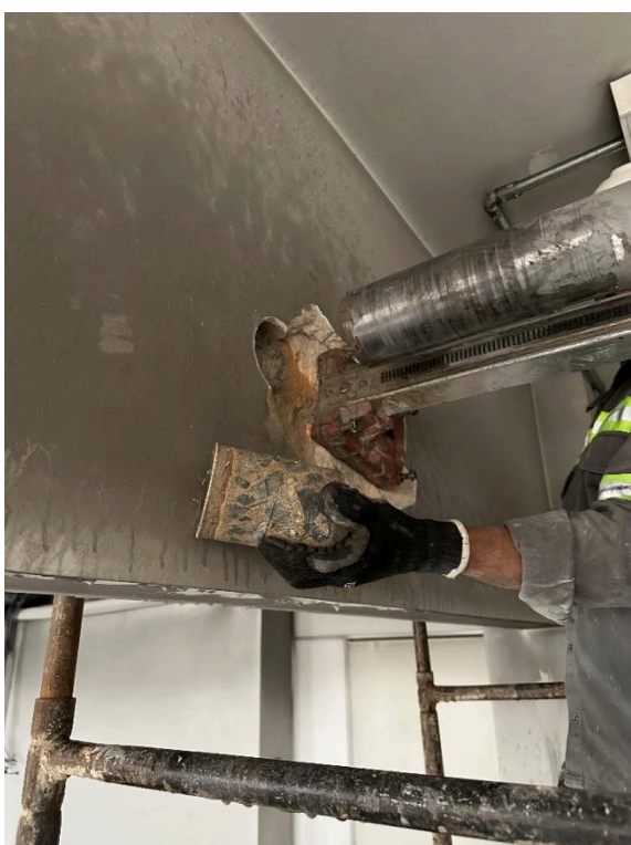
Foto 4: Testemunho retirado da viga fora da área afetada pelo incêndio
