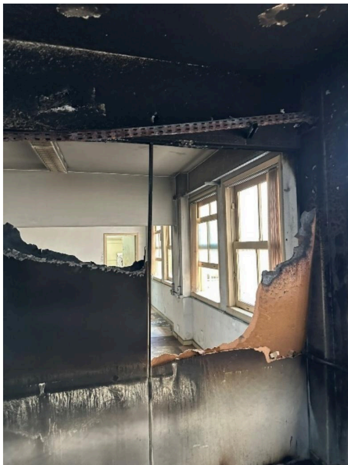
Foto 19: Vista da viga e divisória danificada
