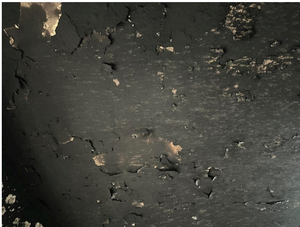
Foto 12: deslocamento e fissuras na laje
